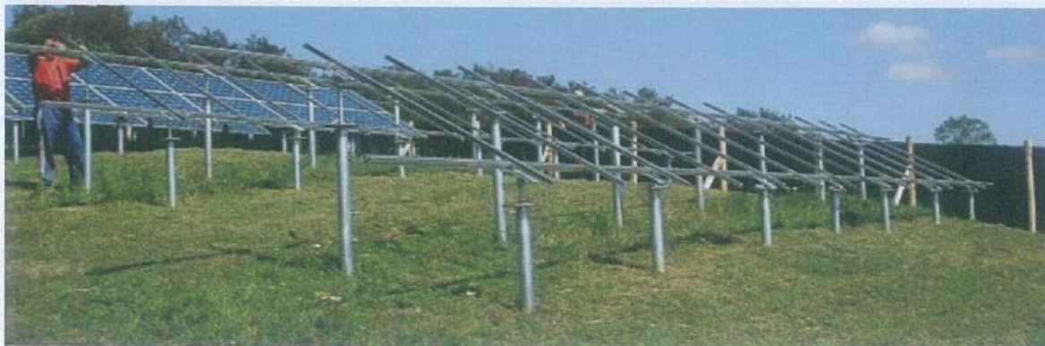
Figure 7: Pamje e strukturave modulare për vendosjen e paneleve fotovoltaike
